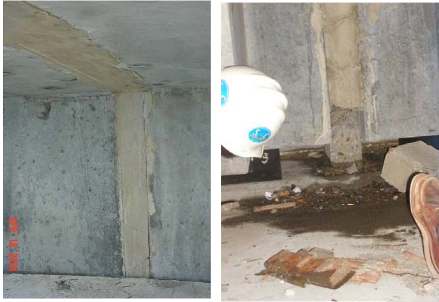
Figure 9 Closure Pour Cracking
